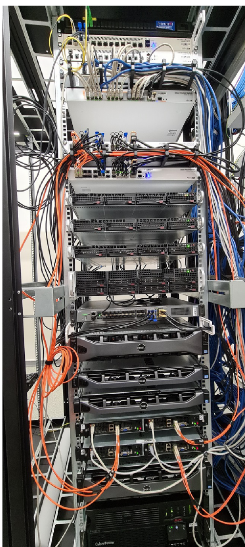
Obrázek 19: Servery pro provoz interních systémů a síťové prvky
