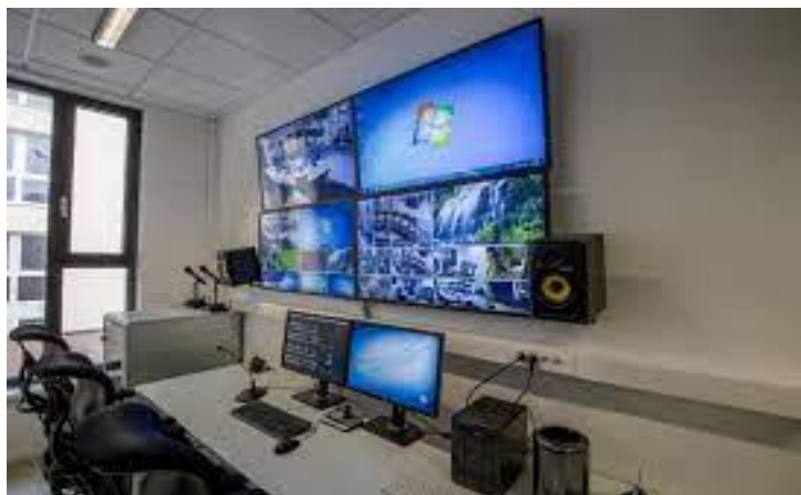
Obrázek 6 - Kontrolní místnost HUBRU (Sloup, 2016)
