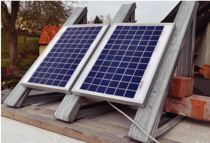
Obr. 17 Fotografie uspořádání solárních panelů
