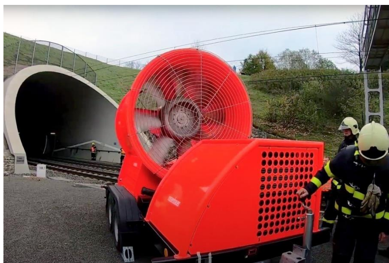
Obrázek 27 Odvětrání tunelu pomocí tunelového ventilátoru (zdroj: HZS SŽ)
