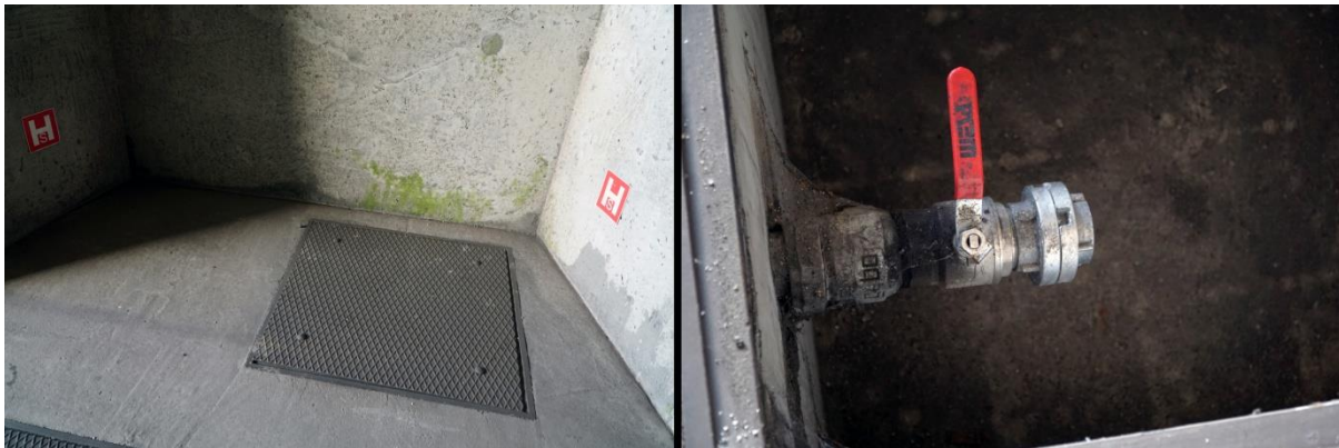
Obrázek 12 Výstup suchovodu pod ocelovým poklopem (zdroj: autor)
