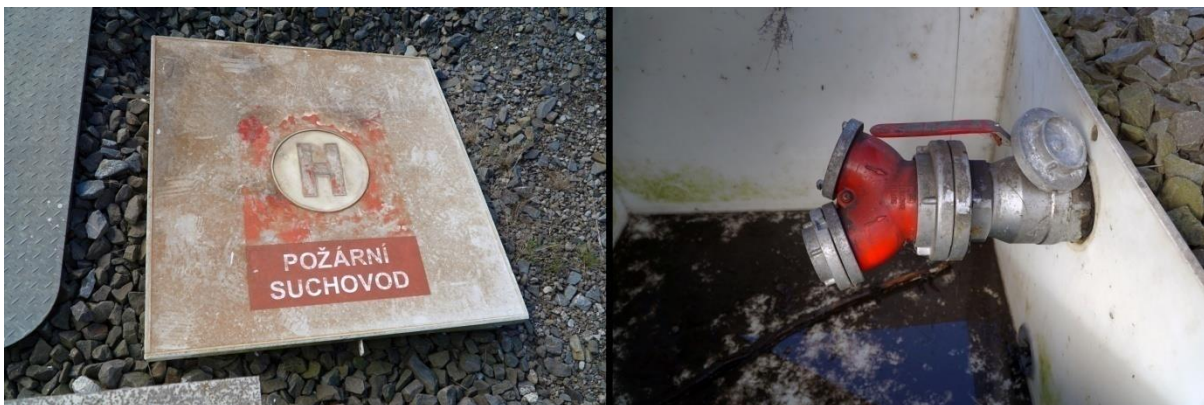
Obrázek 11 Přípojné místo pro zavodnění suchovodu (zdroj: autor)
