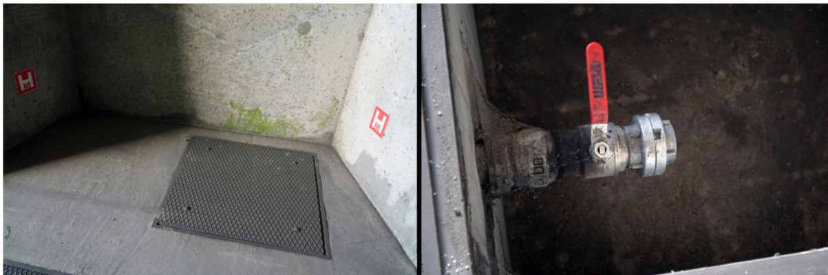
Obrázek 12 Výstup suchovodu pod ocelovým poklopem (zdroj: autor)
