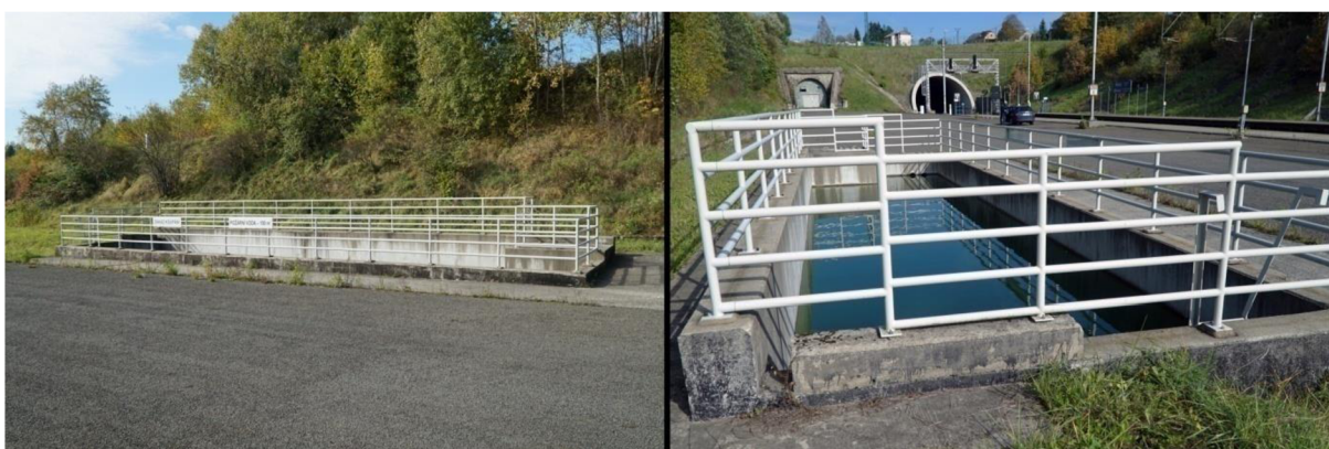
Obrázek 15 Požární nádrž na jižní nástupní ploše (zdroj: autor)
