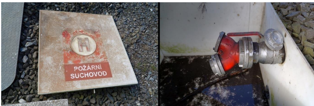
Obrázek 11 Připojné místo pro zavodnění suchovodu (zdroj: autor)
