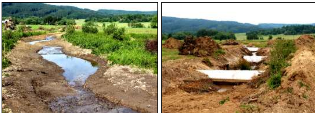
Obrázek 11 Průběh realizace opatření "Revitalizace potoka " v k.ú. Nemanice Zdroj: Státní pozemkový úřad, 2021
