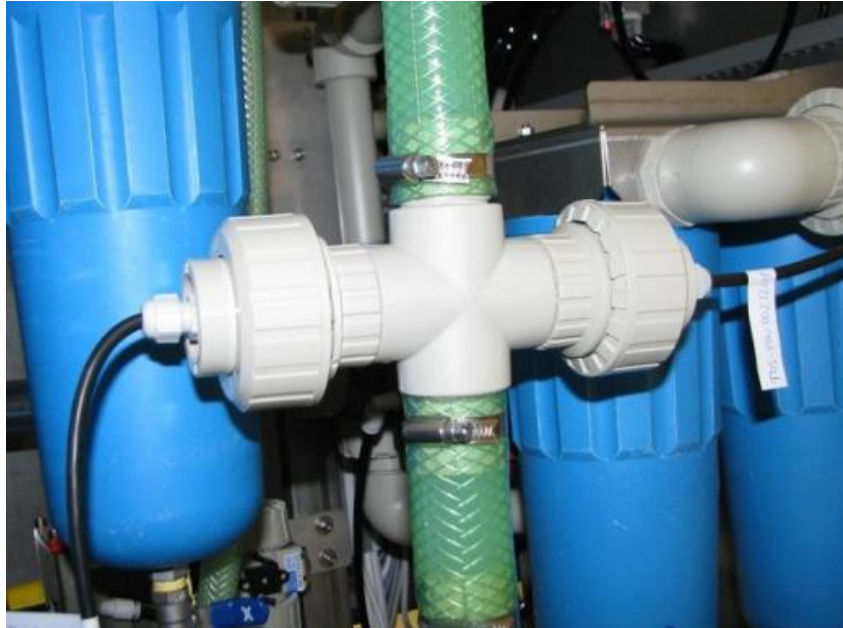
Obr. 57 Fyzická instalace dvojice snímačů v tlakovém rozvodu
