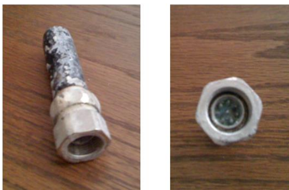
Obr. 36 Koroze konektorového spojení snímačů
