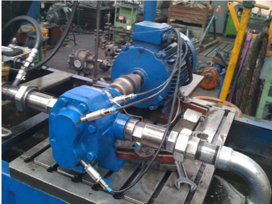
Obr. 40 Čerpadlo osazené snímači pro monitorování třecího tepla
