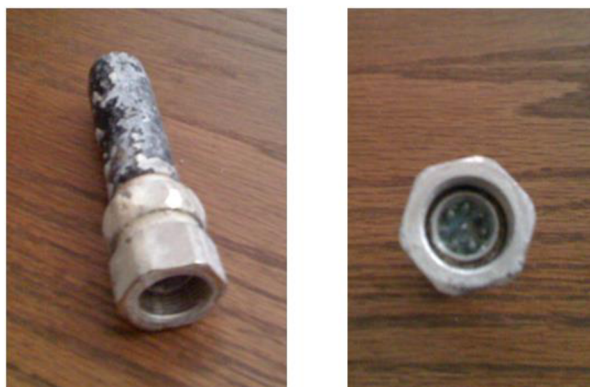
Obr. 36 Koroze konektorového spojení snímačů
