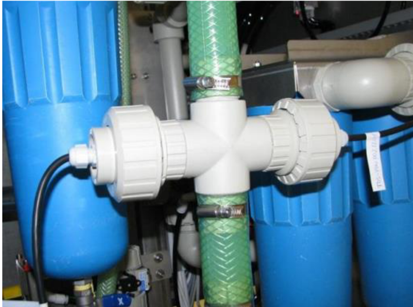
Obr. 57 Fyzická instalace dvojice snímačů v tlakovém rozvodu
