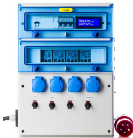
Obr. 3: Rozvodová skříň Growduino [4]
