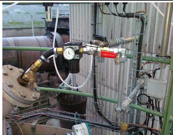
Obr. 2.6 Potrubí CO 2 . Korozivzdorné: CO 2 , bílá flexi hadice: vzduch
