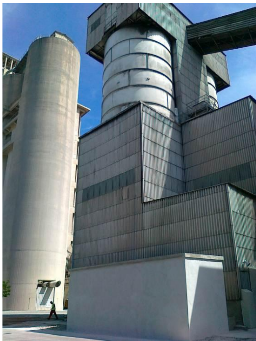
Obr. 6.2 Mlýnice před montáží filtru
