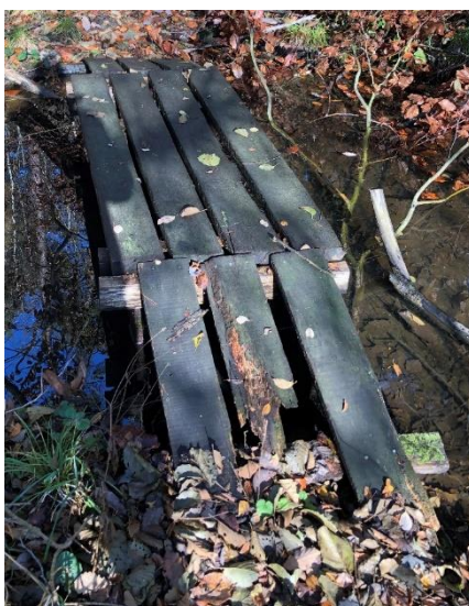
Obr. 84 Lávka MOS35 se zdegradovanou částí fošen
