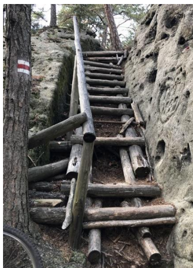
Obr. 70 Poškozená konstrukce schodiště MOS18
