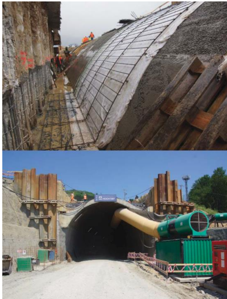
Obr. 19 Ukážka separačnej vrstvy a montáž výstuže, vyrazenie opery pod želvou a prestriekanie jej podpôr primárnym ostením, tunel Považský Chlmec D3 [22]
