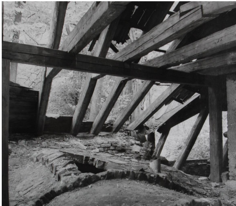
Obr. 10: Destruovaná střešní krytina na budově pod věží
