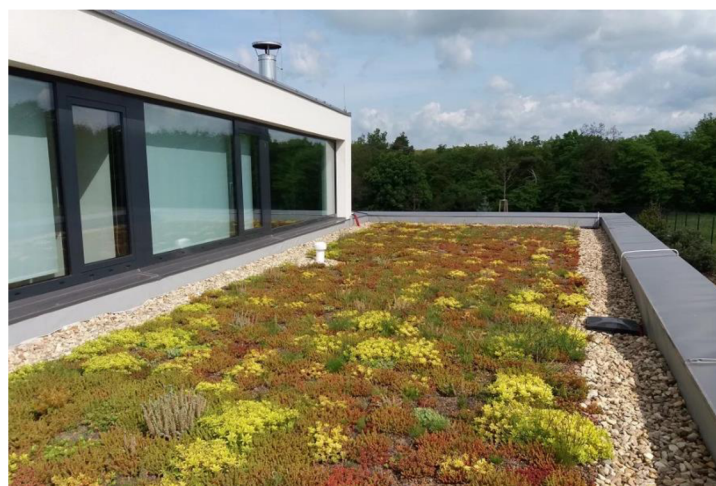
Obr. 22 - Extenzivní zelená střecha [49]
