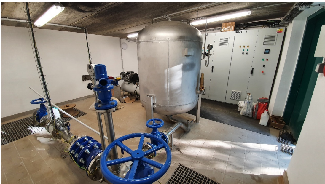
Příloha 4: Bývalá „vrátkovna“ v Křešicích nově vybavena technologií k jímání vody ze štolového přivaděče
