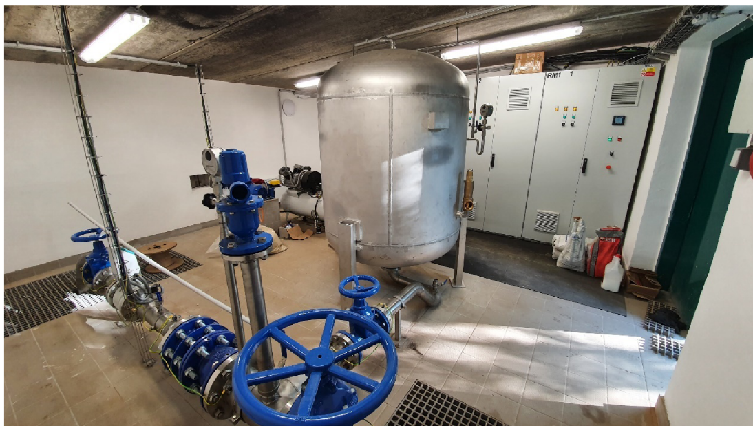
Příloha 4: Bývalá „vrátkovna“ v Křešicích nově vybavena technologií k jímání vody ze štolového přivaděče
