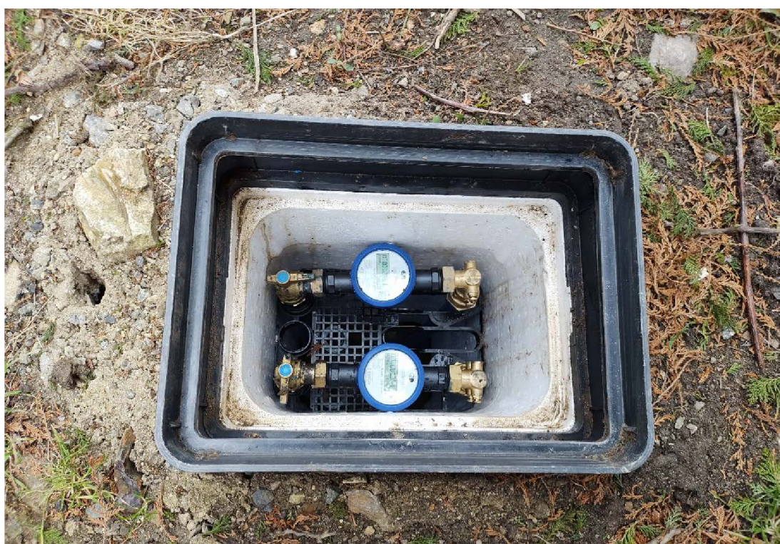
Příloha 7: Uložená vodoměrná šachta v zemi včetně osazených vodoměrů
