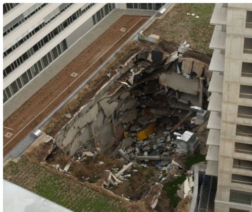
Obr. 4 Havárie polyfunkčního komplexu Trinity, Bratislava, 2012 [3]
