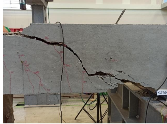
obr. 7.15: detail porušení nosníku – vzorek B [ 19 ]
