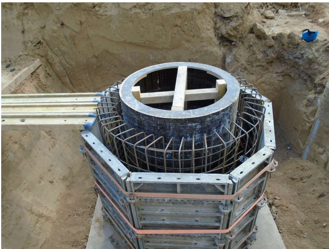
Obr. 9.3 Přečerpávací jímka [vlastní tvorba autora]
