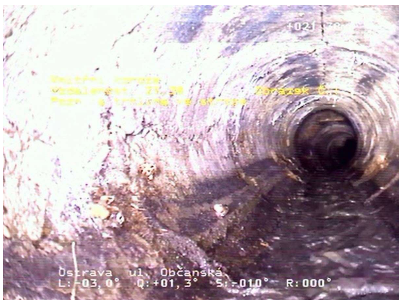
Obr. 37 Koroze a podélné trhliny na úseku U11 [OVAK a.s.]
