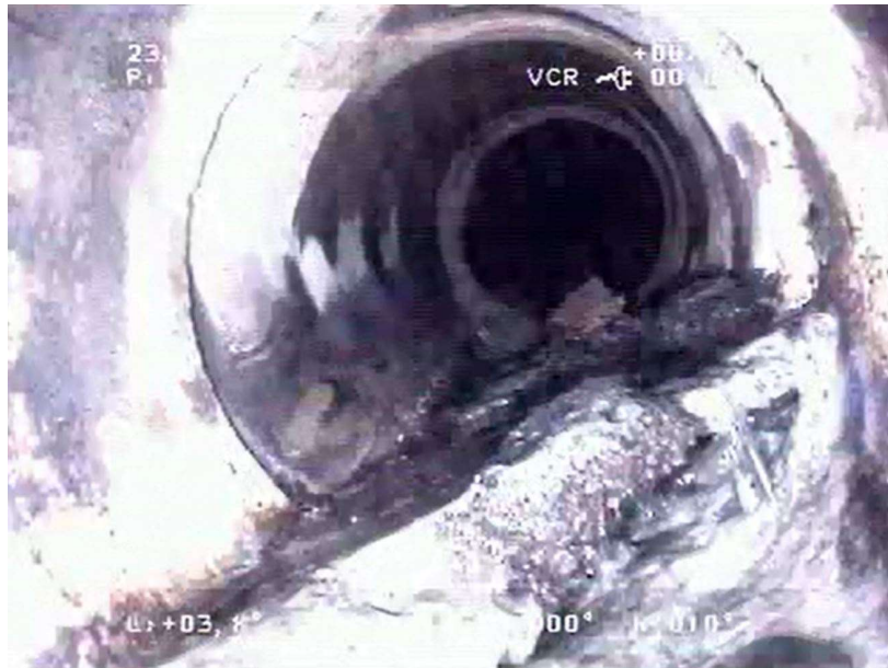
Obr. 24 Překážka v odtoku na úseku u28 [OVAK a.s.]
