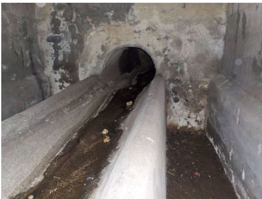
Obr. 4 Vnitřní prostory OK Na Baranovci [OVAK a.s.]
