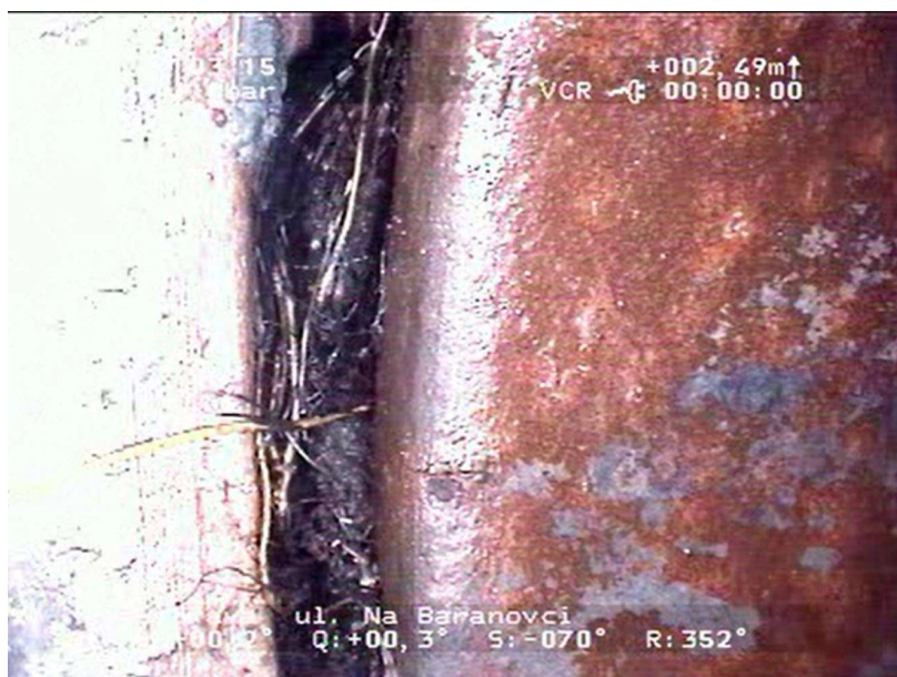
Obr. 25 Netěsný spoj na úseku u29 [OVAK a.s.]
