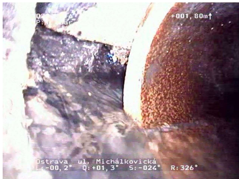
Obr. 39 Chybějící část stěny na úseku U16 [OVAK a.s.]
