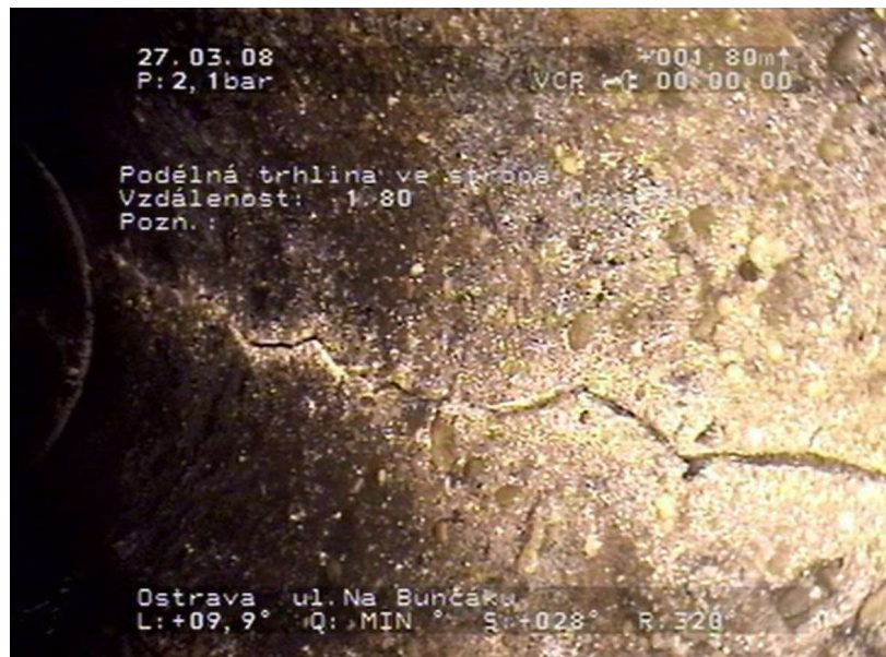
Obr. 29 Podélná trhлина na úseku u05 [OVAK a.s.]
