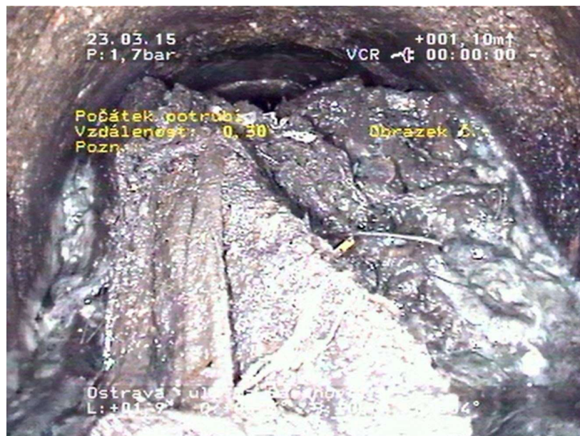
Obr. 23 Překážka v odtoku na úseku u26 [OVAK a.s.]
