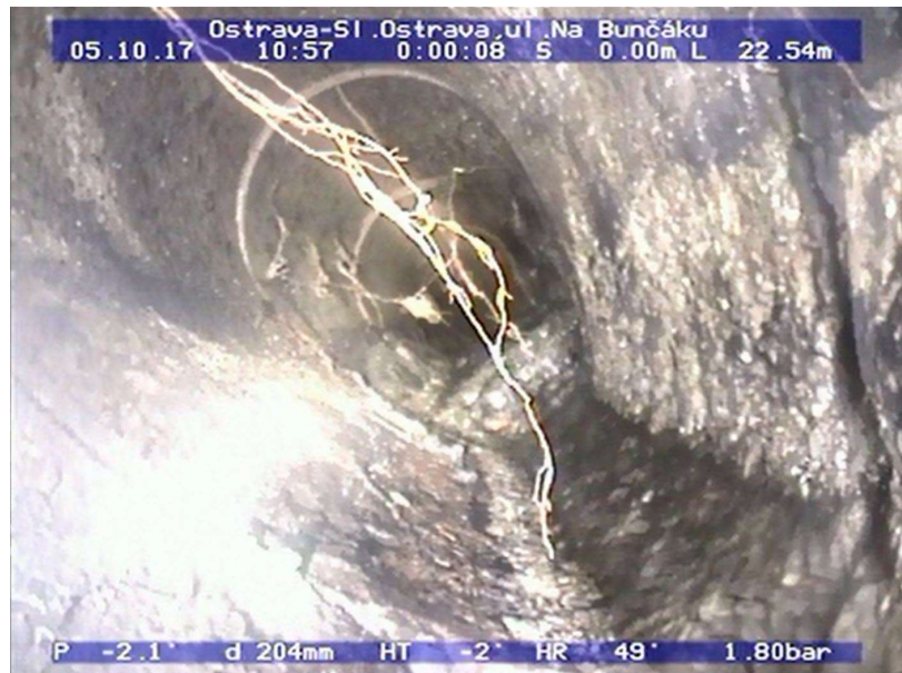
Obr. 34 Silná koroze a netěsnost spojů na úseku u17 [OVAK a.s.]
