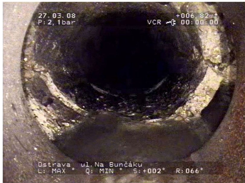
Obr. 28 Netěsný spoj na úseku u05 [OVAK a.s.]
