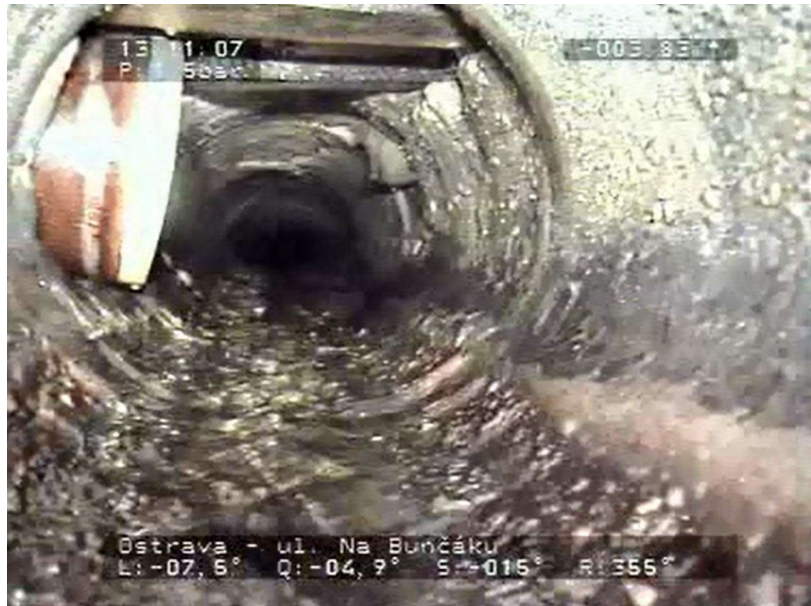
Obr. 26 Silná koroze na úseku u01 [OVAK a.s.]
