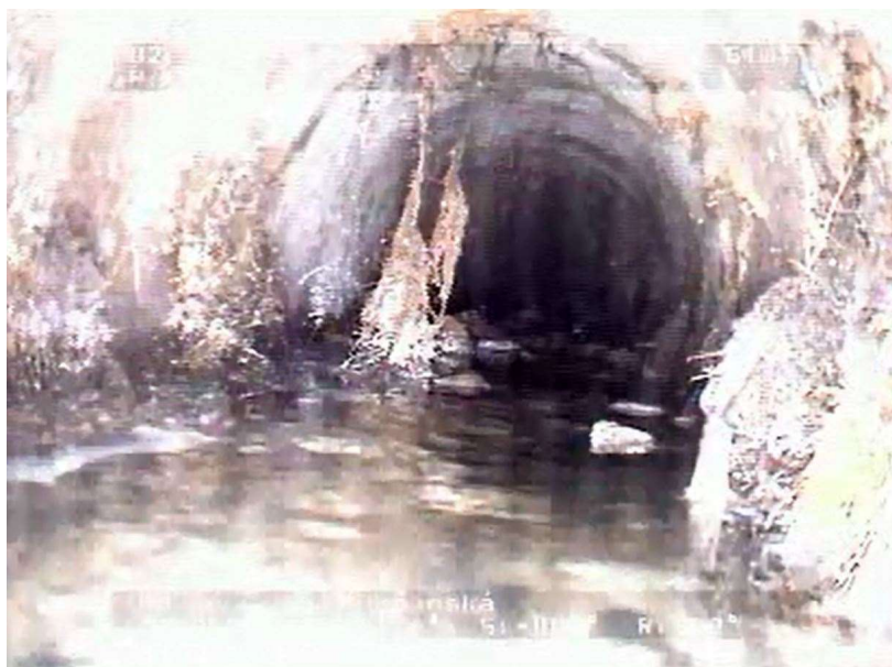
Obr. 36 Chybějící části stěn a vrůstající kořeny na úseku U10 [OVAK a.s.]
