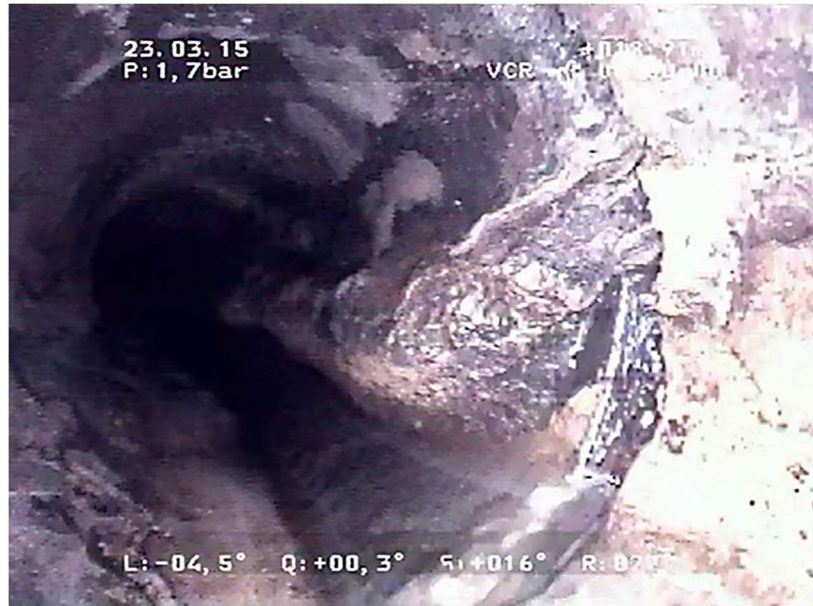
Obr. 22 Překážky v odtoku na úseku u25 [OVAK a.s.]
