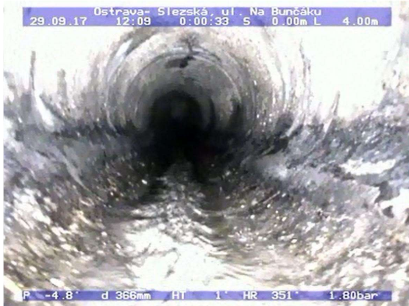
Obr. 31 Koroze na úseku u07 [OVAK a.s.]
