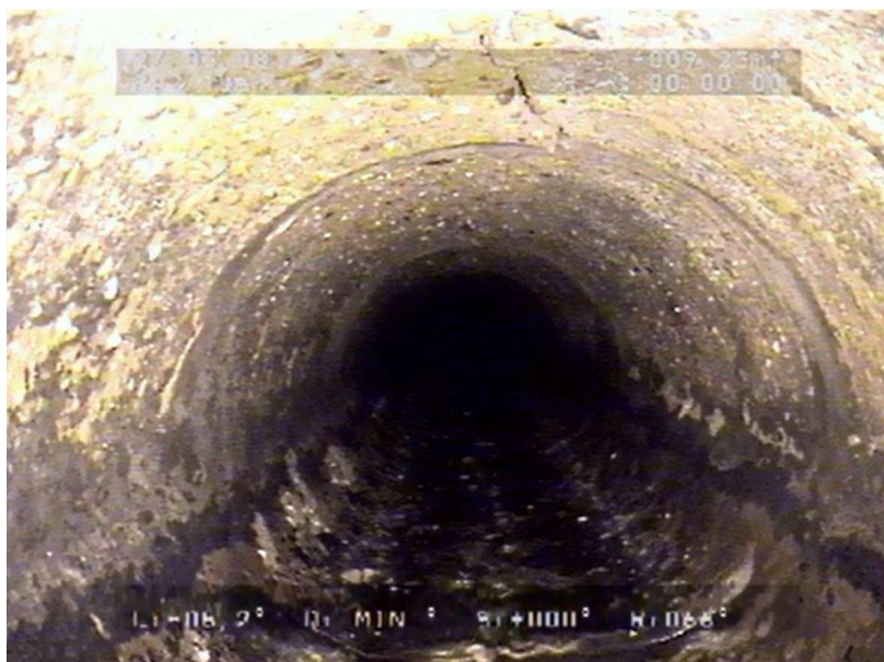
Obr. 32 Deformace potrubí na úseku u08 [OVAK a.s.]
