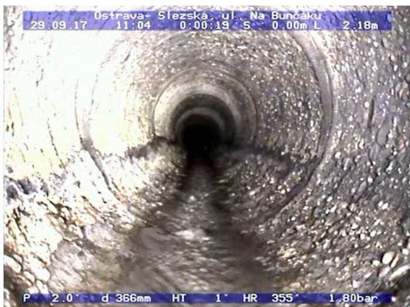
Obr. 33 Koroze na úseku u09 [OVAK a.s.]
