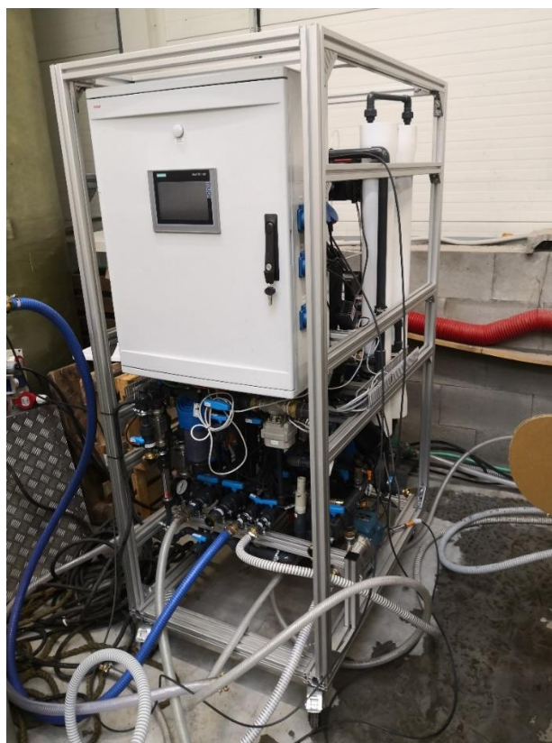
Obrázek 32: Fotodokumentace z lokace průmyslové prádelny – řídicí jednotka
