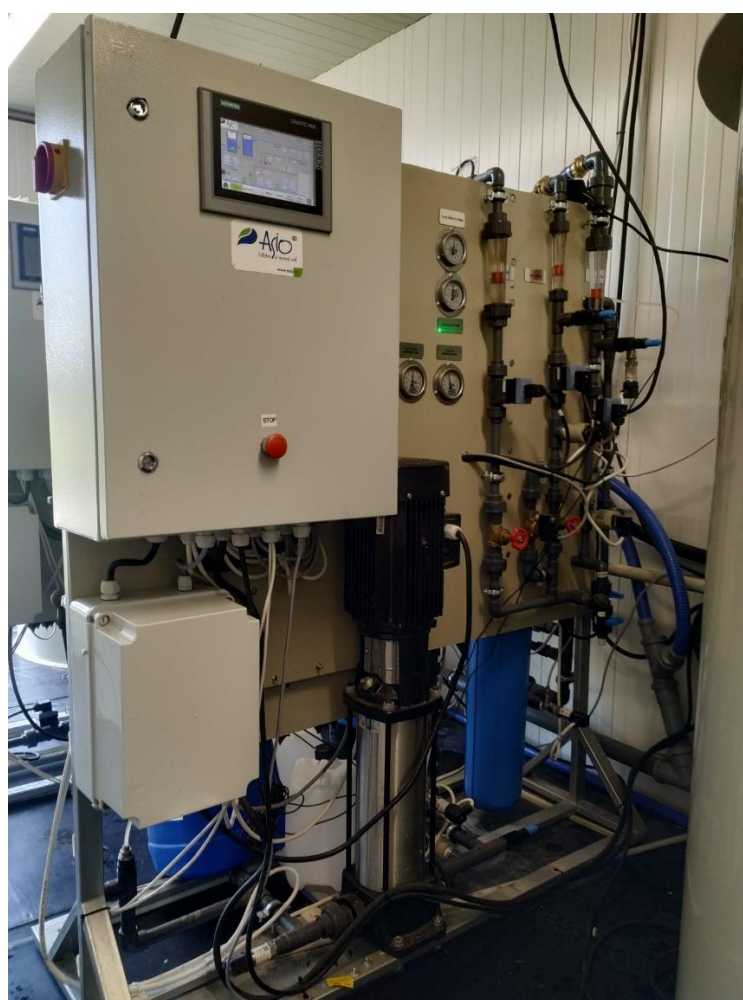
Obrázek 30: Fotodokumentace z lokace ČOV – řídicí jednotka
