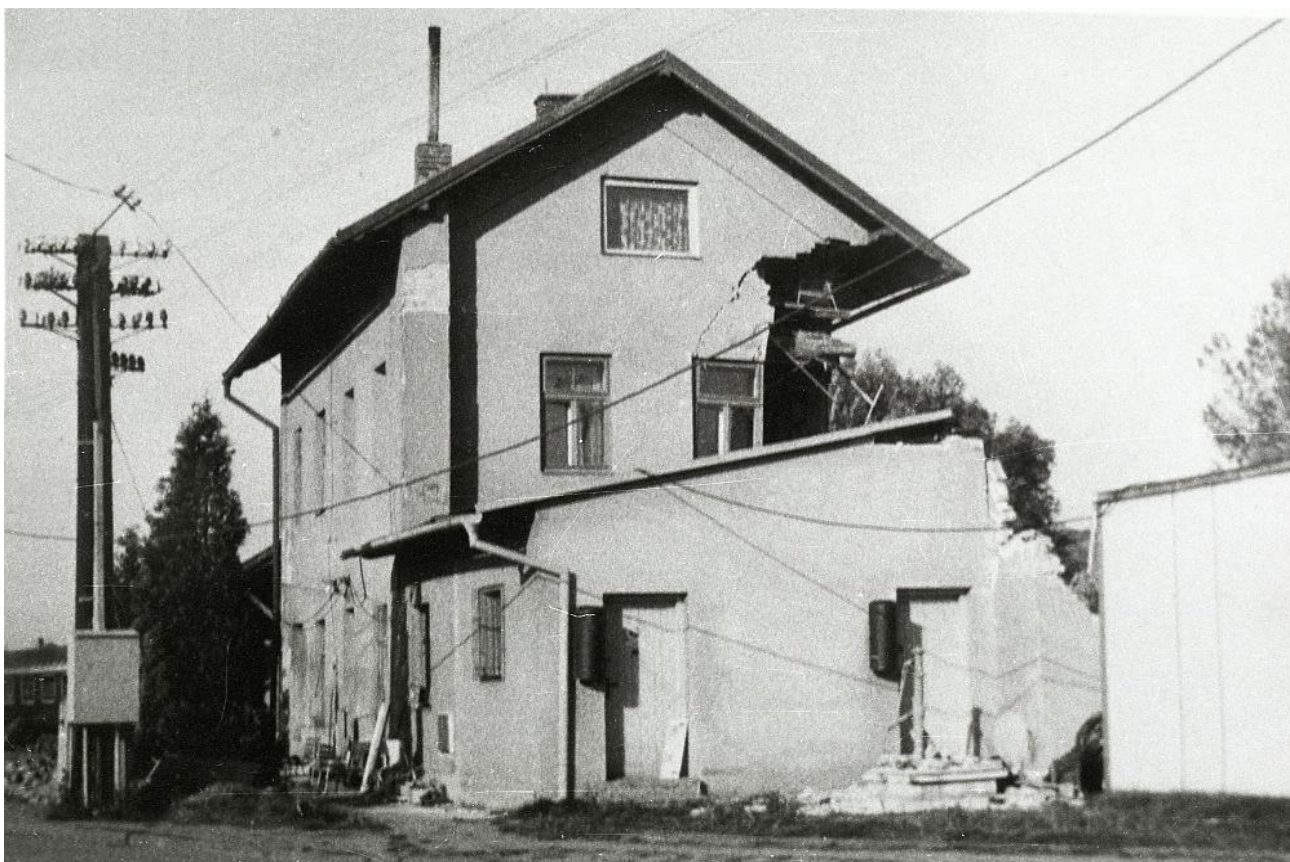
60/ Hradčovice, výpravní budova po železniční nehodě v roce 1988, pohled od silnice.
