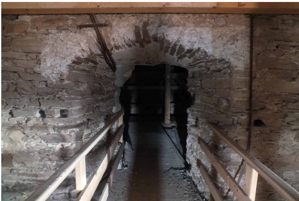
Příloha č. 89: Vchod do renesanční přístavby věže z půdy kostela. Fotografie z roku 2019.
