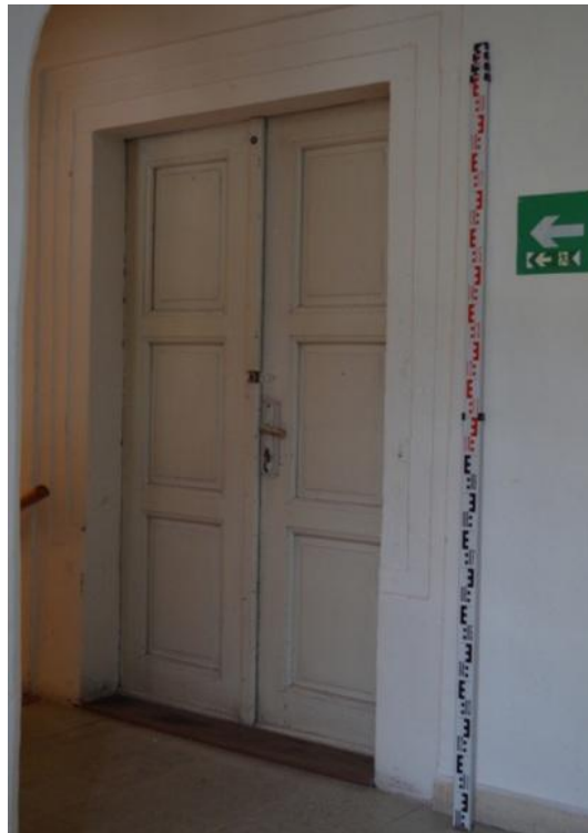
33. Frýdecký zámek, Frýdek – renesanční portál s ostěním s pravouhle zalomenou profilací – ve 3. podlaží jižního křídla
