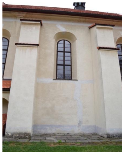
68. Kostel sv. Martina, Skalice – pohled na jižní stranu, zazděný vstup se segmentovým obloukem
