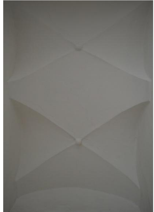
35. Frýdecký zámek, Frýdek – podesta mezipatra zaklenutá křížovou klenbou s hřebínky s kovovými čočkami v průnicích, jižní křídlo
