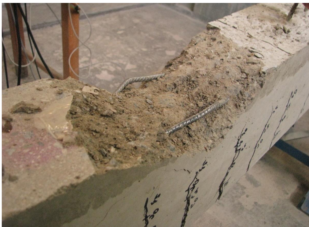
Obr. 2.22 Odkrytá vybočená výztuž
