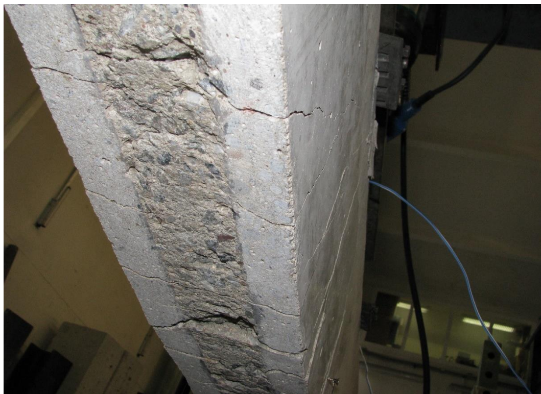
Obr. 2.30 Trhliny v tažené části betonu
