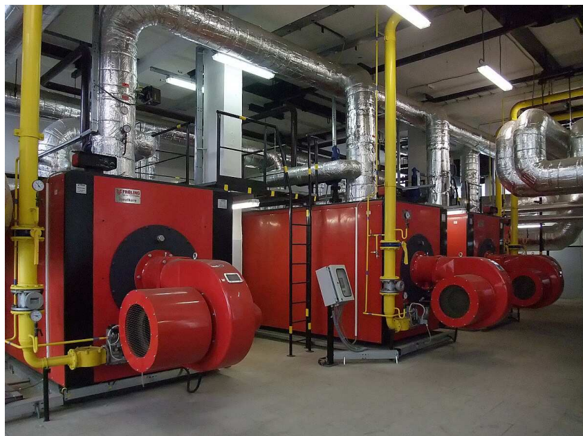
Obr. 22 Plynové kotle DYNATHERM
