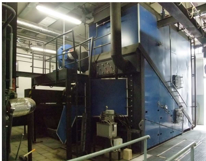
Obr. 20 Kotel VESKO-B 1,5 MW
