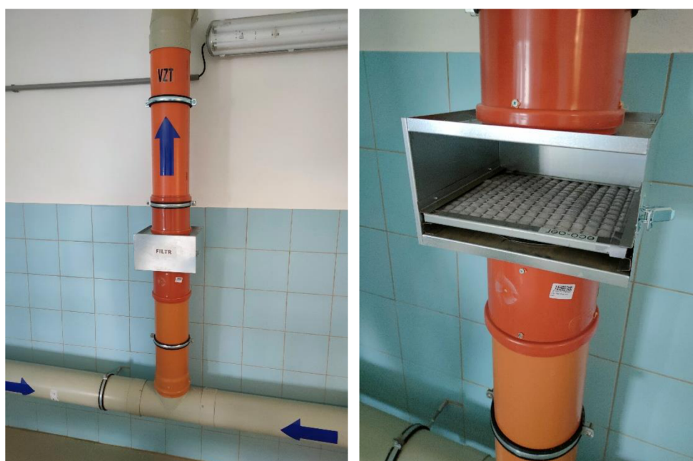
Obr. 3.8 VDJ Suchohrdly – vzduchový filtr. Foto Marie Bergerová
