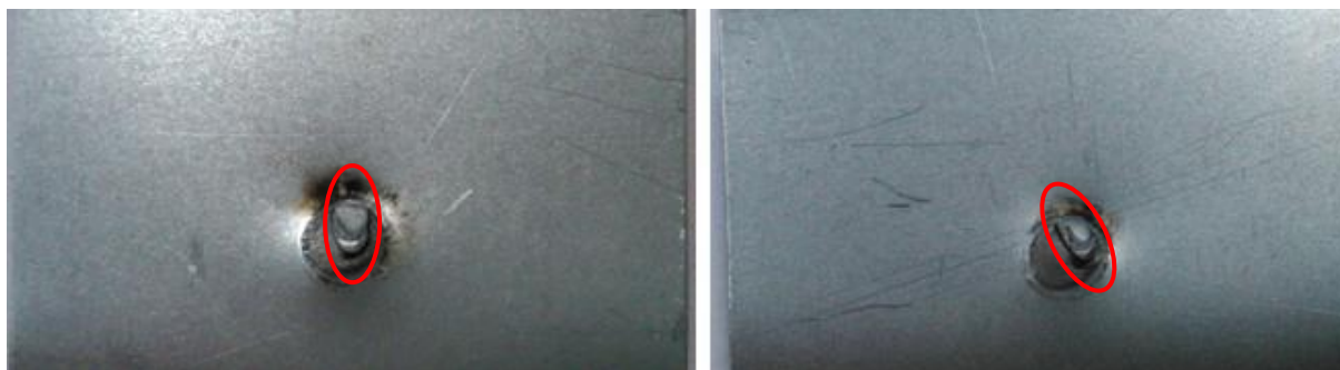
Obr. 11.15: Ukázka nevyhovujících (nesymetrických) svarů
