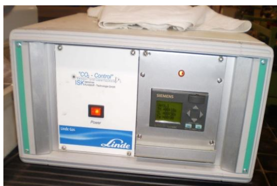
Obr. 9.3: Zařízení SIEMENS pro kontrolu kapalného oxidu uhličitého.
