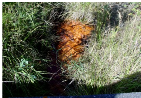
Obr. č. 17: Železitá voda na VPV (Foto: autor, 2014)
