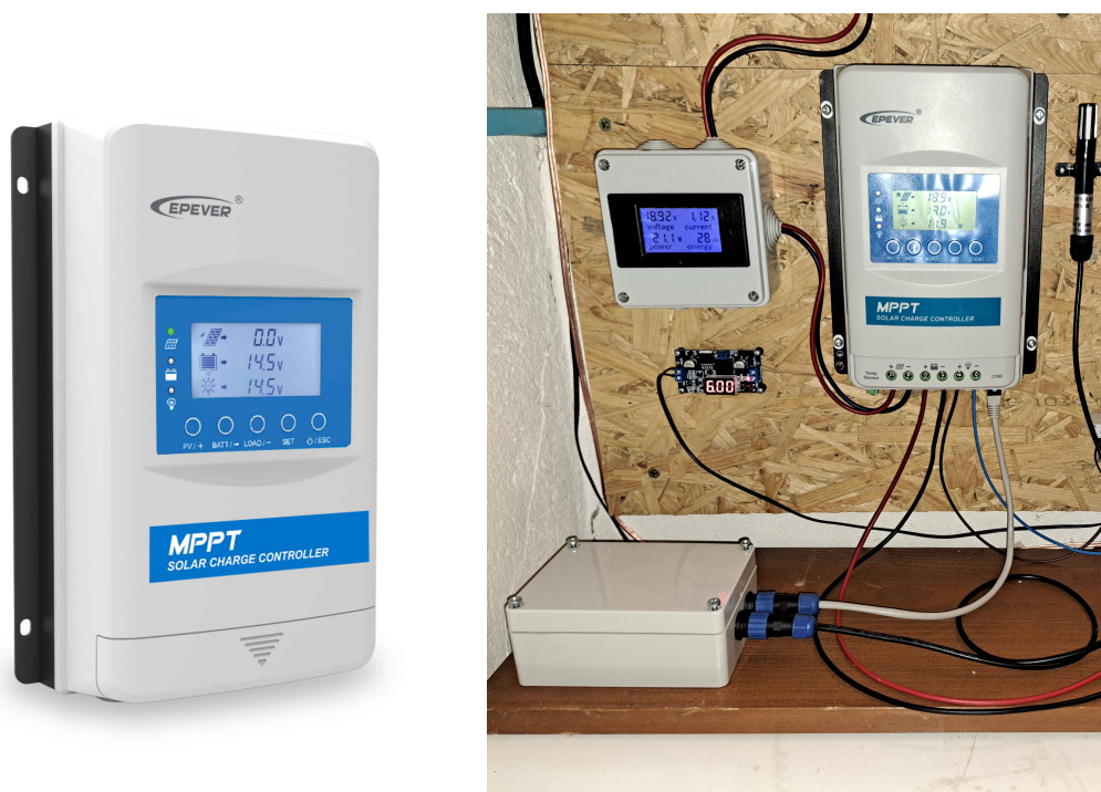
Obrázek 6.4: MPPT regulátor Epever XTRA3210N-XDS2 [75] a realizovaná sestava pro monitorování parametrů fotovoltaické elektrárny
