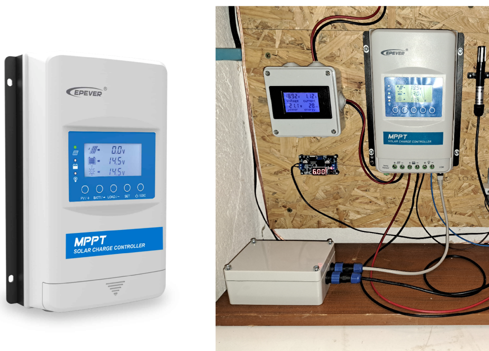
Obrázek 6.4: MPPT regulátor Epever XTRA3210N-XDS2 [75] a realizovaná sestava pro monitorování parametrů fotovoltaické elektrárny
