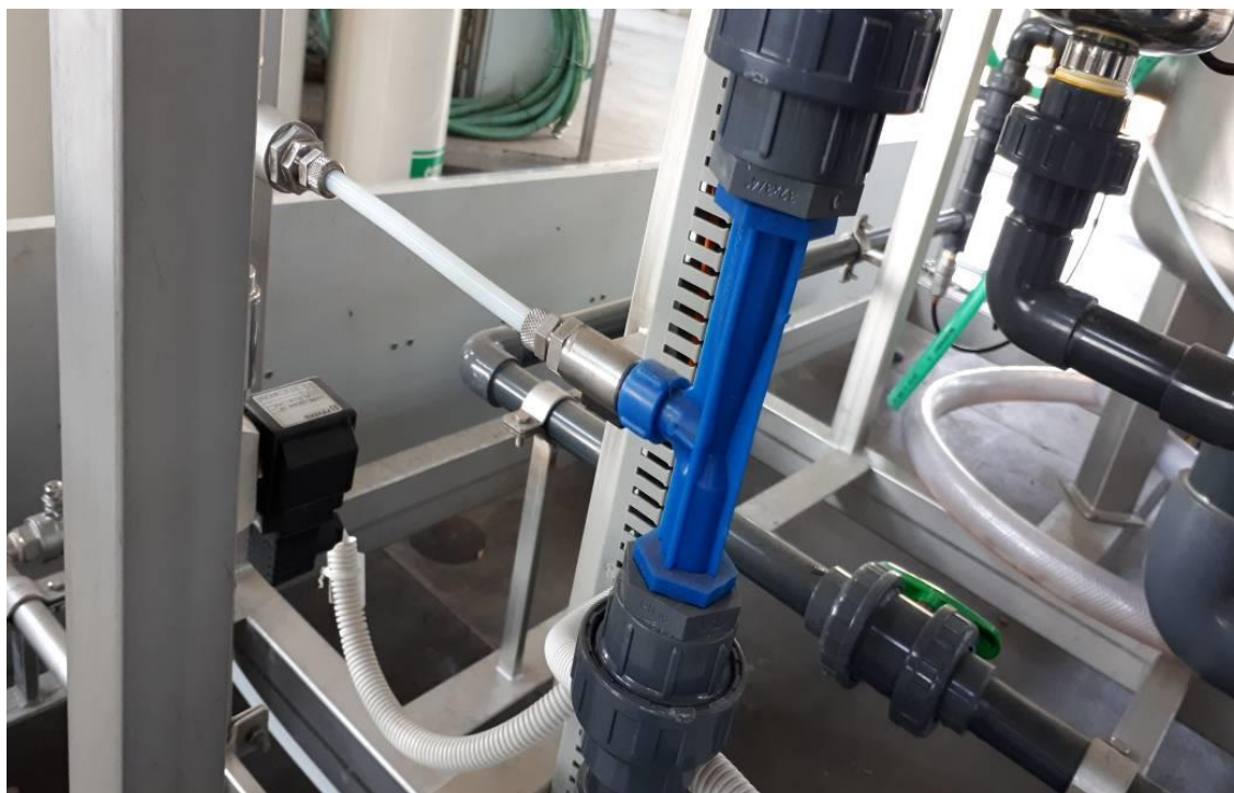
Obr. 16 Pohled na přímý injekční systém jednotky AOP
