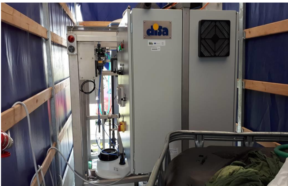
Obr. 37 Pohled na jednotku AOP uvnitř přívěsu
