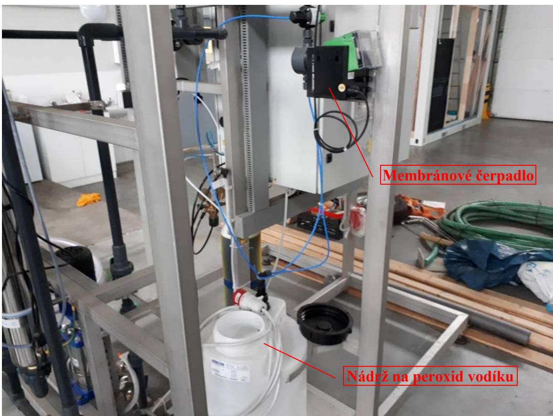
Obr. 22 Pohled na nádrž peroxidu vodíku a membránového čerpadla
