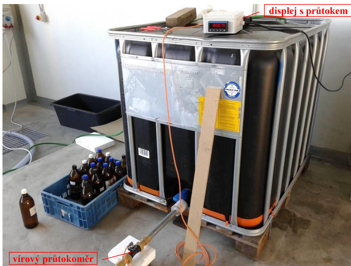
Obr. 25 Pohled na velkokapacitní nádrž o objemu 1000 litrů a vírový průtokoměr s displejem
