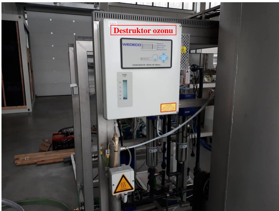
Obr. 24 Pohled na destruktory přebytečného ozonu
