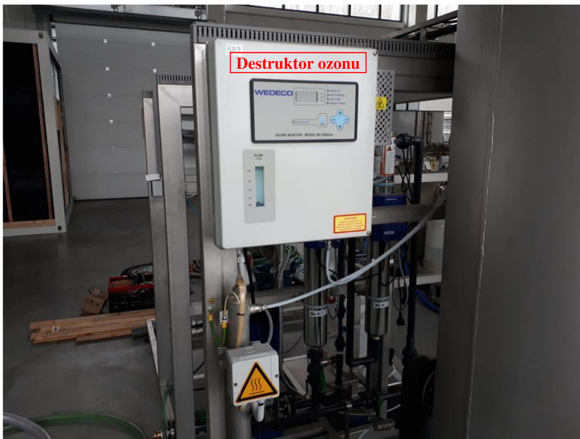
Obr. 24 Pohled na destruktory přebytečného ozonu
