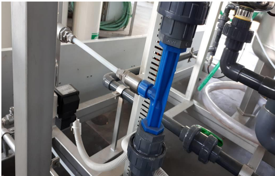
Obr. 16 Pohled na přímý injekční systém jednotky AOP
