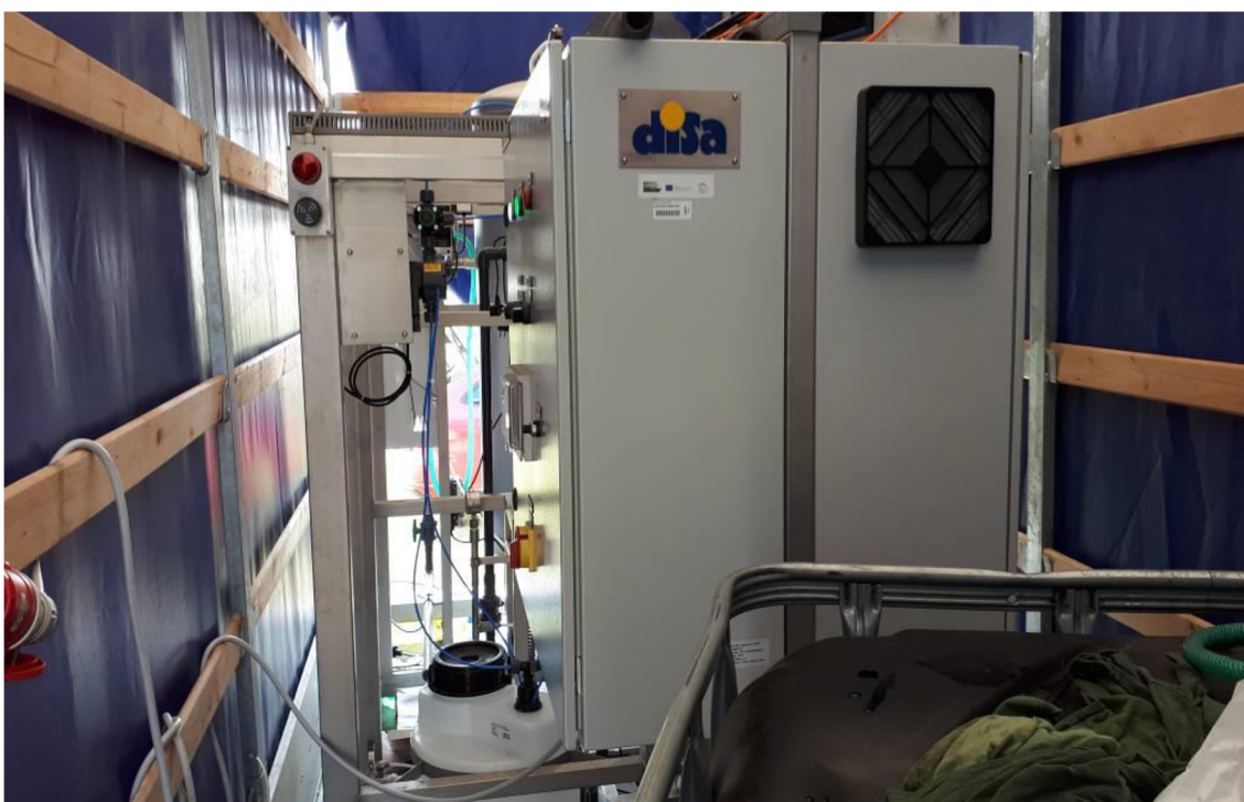
Obr. 37 Pohled na jednotku AOP uvnitř přívěsu
