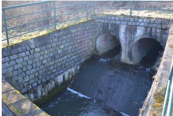
Obr. 16 Propustek a vývar na konci zatrubněného úseku toku pod RN N2 (© S. Mecová, březen 2023)
