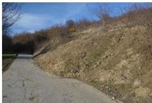
Obr. 18 Sesouvání svahu na J straně deponie (© S. Mecová, březen 2024)
