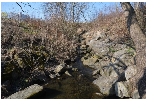
Obr. 15 Balvanitý skluz pod RN N1 (© S. Mecová, březen 2023)
