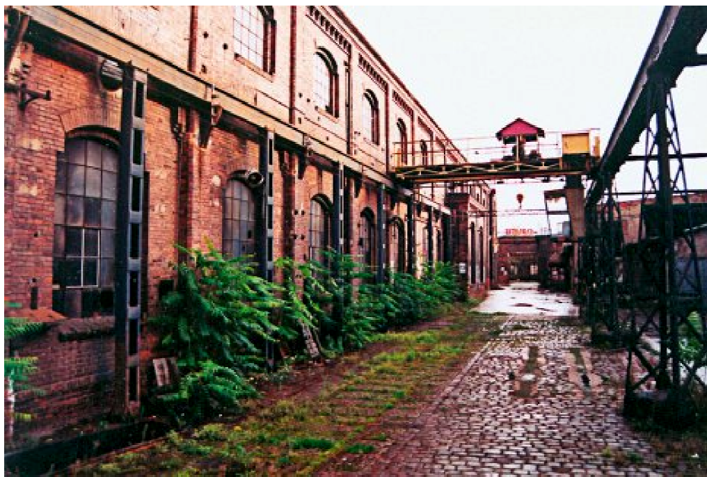
Obr. 13 Zchátralá budova strojírny před rekonstrukcí
