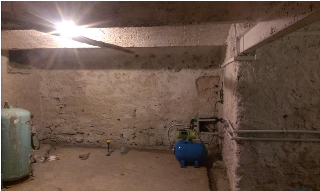
Obr. 31 Vodní pumpa ve sklepě pod schodištěm
