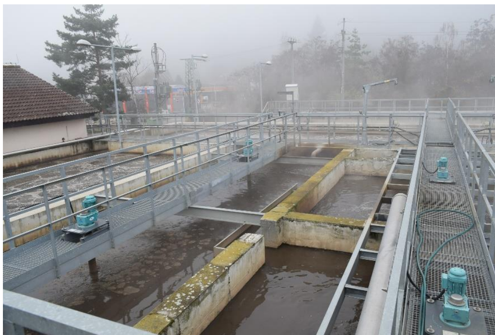
Obrázek 8 Pohled na biologickou linku ČOV Černošice
