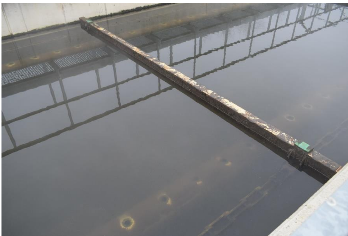
Obrázek 11 Dosazovací nádrž v ČOV Černošice
