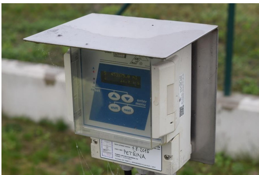
Obrázek 15 Měrný objekt při výtoku vyčištěné vody do recipientu
