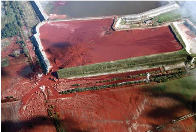
Obr. 7) Protržená hráz na odkališti [19]
