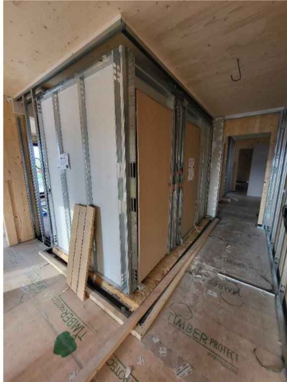
Obrázek 4 - Koupelnový modul Sanika osazený v rozestavěné bytové stavbě z CLT panelů (autor práce, 2023)
