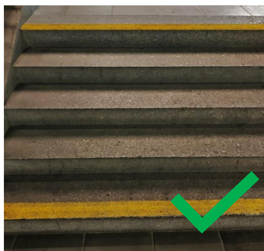
Obr. 22 – Správné značení schodiště (pouze na horní hraně)
