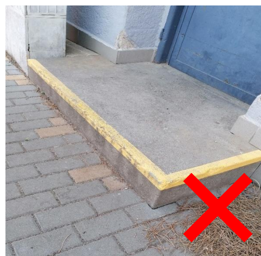
Obr. 23 – Špatné značení schodu (značka i na přední hraně)
