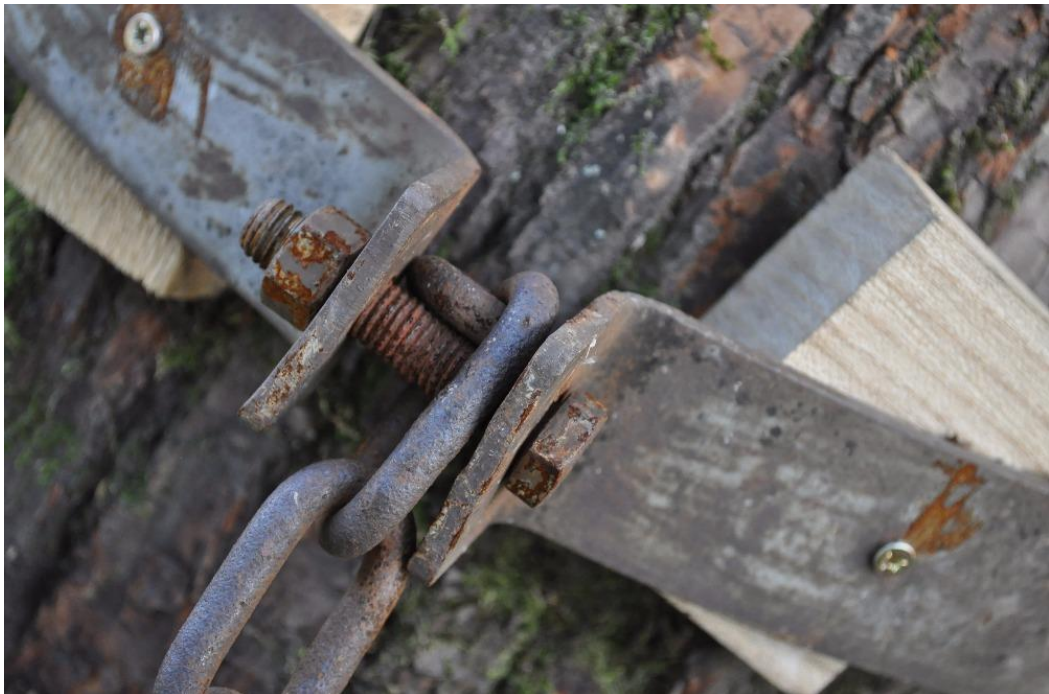
Obr. 65 Jiřická lípa, výměna jen dřevěných podkladnic bez výměny celé vazby, foto: Petr Zvědělík ,září 2015
