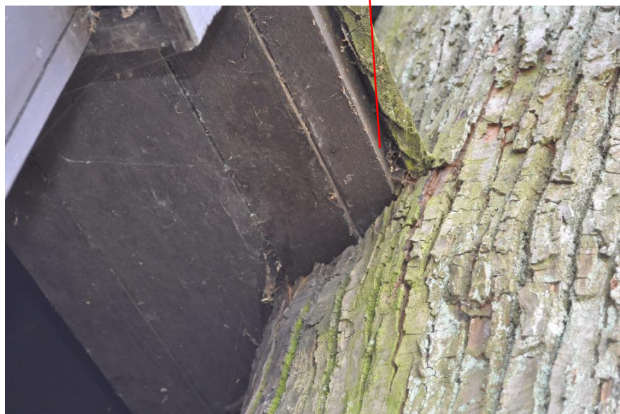
Obr. 26 Klokočovská lípa - vyříznutý zádlab pro upevnění trámu až do živého těla lípy, foto: Petr Zvědělík, duben 2015
