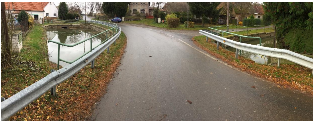
Obrázek 16: Požární nádrže Na Návsí 1 a Na Návsí 2 v Chrástu, fotografie autor, rok pořízení 11/2019
