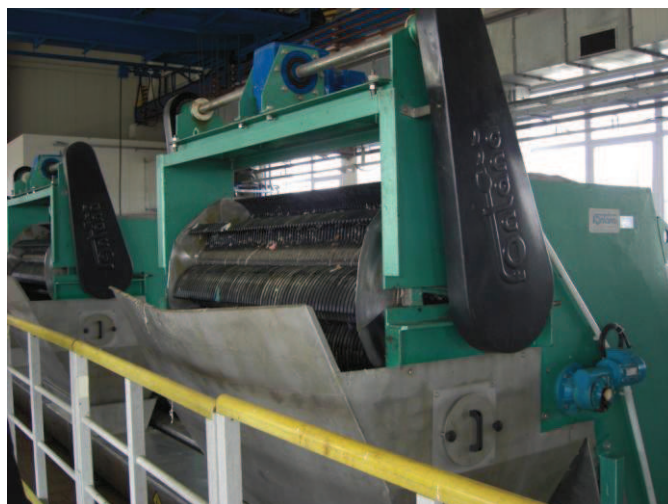
Obr. 3 Strojní česle na ČOV Brno-Modřice
