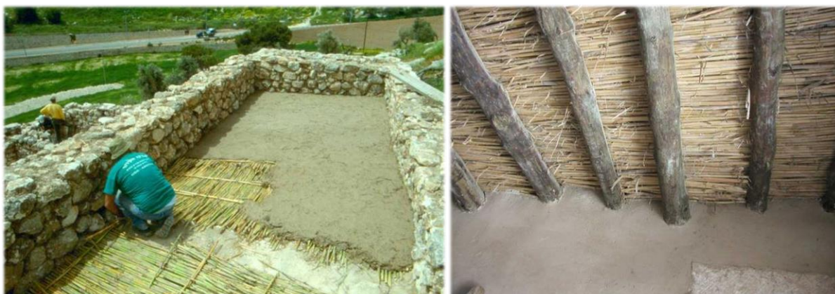
Obr. č. 18 Rekonstrukce nazaretských domů tradičním způsobem. Mazání rákosového záklopu hlinou (vlevo) a pohled na strop/terasu z interiéru (vpravo). Stropní trámy z kuláčů nesou desku z hliněné mazaniny na pletenině z proutí. Zdroj: https://www.nazarethvillage.com/about/research-and-archaeology/the-houses/roofs/
