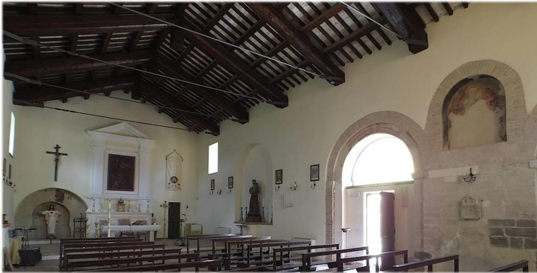
Obr. č. 19 Opatství Santo Stefano di Parrano v Itálii (11. stol.). Podélné vodorovné trámy (vlašské krokve) uloženy na mohutných nosnících (v podstatě prostá krokevní vazba) sedlového tvaru nesou svislé latě s krytinou. Zdroj: https://www.iluoghidelsilenzio.it/abbazia-di-santo-stefano-di-parrano-nocera-umbra/
