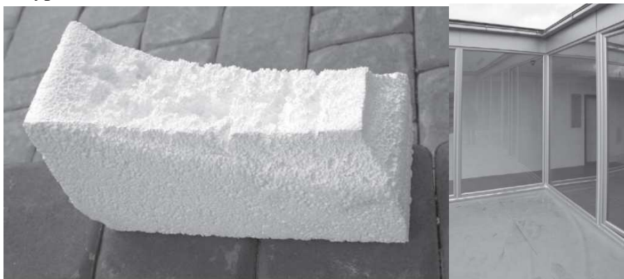
obr. 1.1 Příklad poškození EPS v blízkosti proskleného atria [3]
