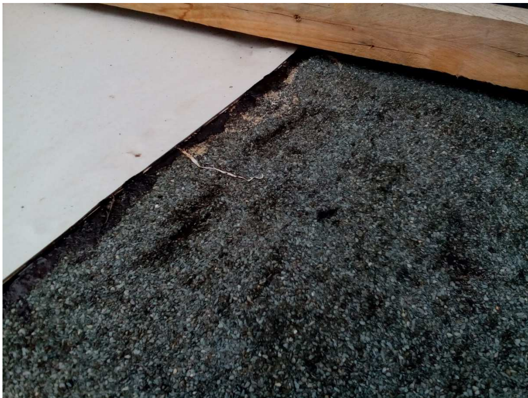
Obr. F.3 Poškození povrchu asfaltové krytiny 14. září 2015
