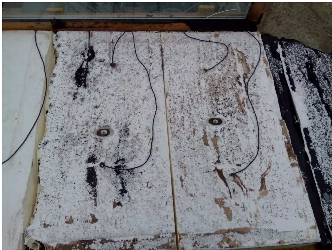
Obr. F. 6 Vzhled desek EPS po stržení asfaltového pásu 14. září 2015
