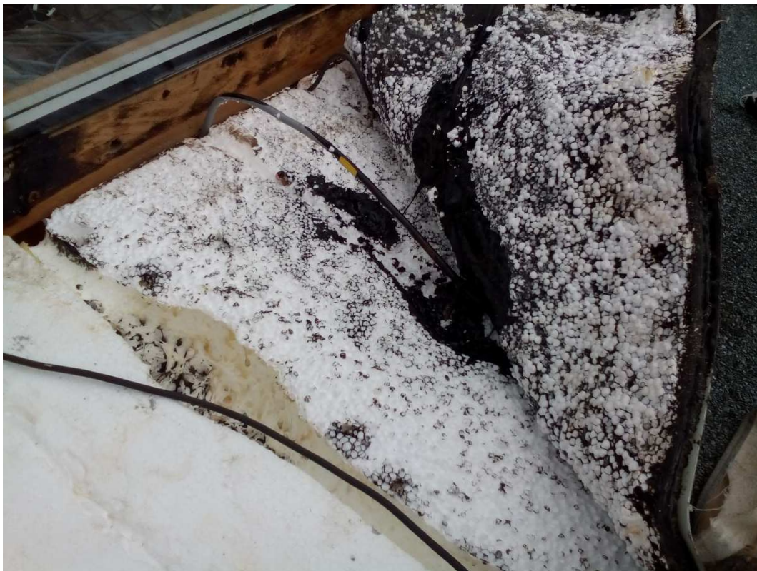
Obr. F. 5 Výrazná akumulace tepla v místě umístění teplotní sondy Asfalt 1 14. září 2015
