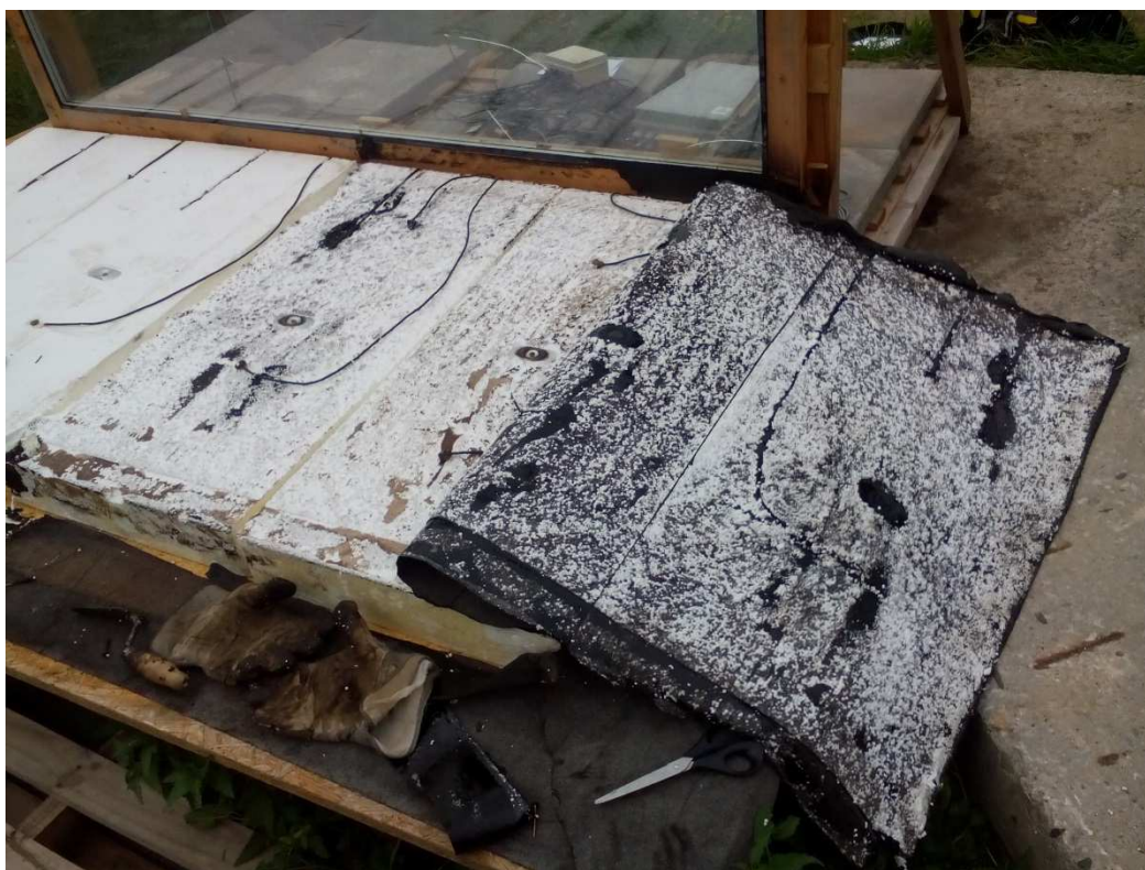
Obr. F.4 Strhnutí asfaltové hydroizolace z EPS 14. září 2015
