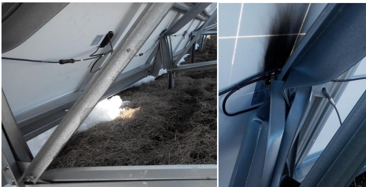
Obr.1.2 Deformácia konštrukcie pod tiažou snehu
