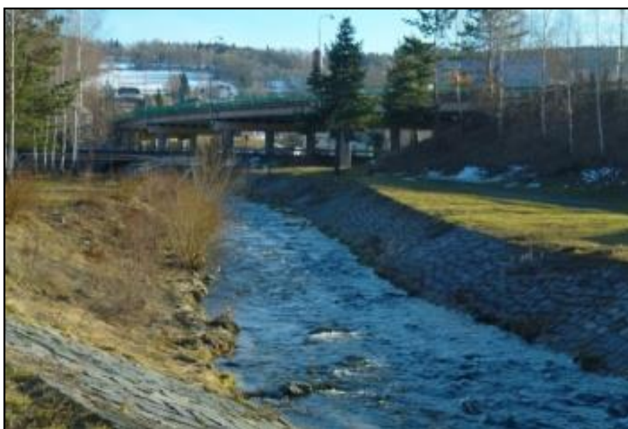
Příloha č. 7: Vydlážděné a nedostatečně osázené koryto toku Volyňka (Autor, 2013)
