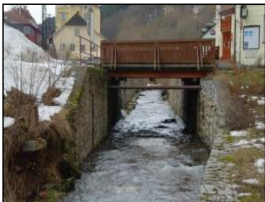
Foto č. 4: Skutečnost – most Vimperk, ul. Pasovská (Autor, 2013)
