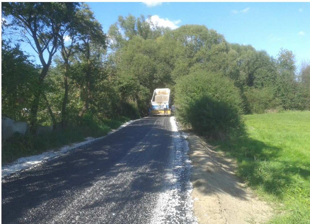
Foto č. 8: Rekonstrukce stávající polní cesty C2 „Pod Jívou“, v době realizace
