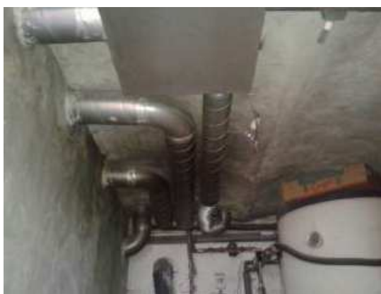
Obr. č. 47 a: Spiro potrubí v kotelně (foto Rosskohl).
