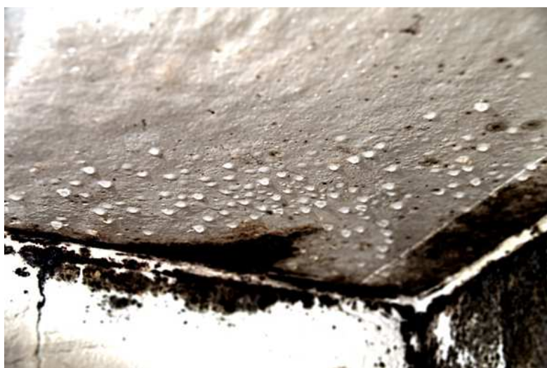
Obr. č. 20: Projev tepelného mostu v rohu místnosti s výskytem kondenzátu a plísní (16).
