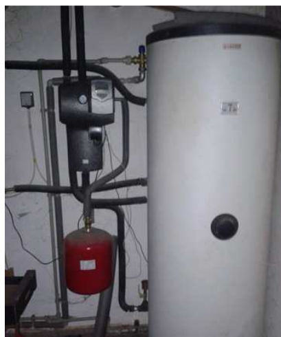
Obr. č. 48 b: 300 l zásobník ohřáté vody a vlevo řídicí jednotka (foto Rosskohl).
