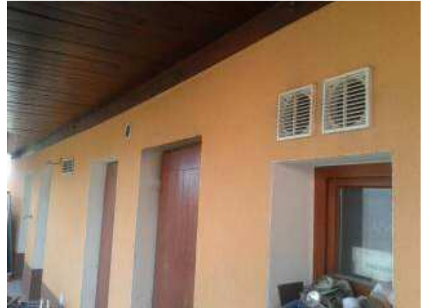
Obr. č. 47 d: Mřížkami kryté přívody (dále) a odvody vzduchu jednotek nuceného větrání (foto Rosskohl).
